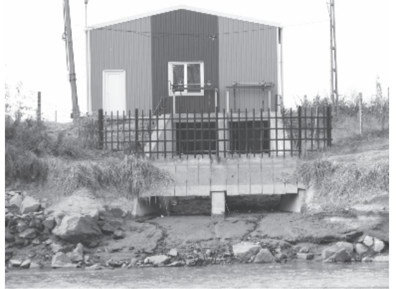
Feliszapolódott vízkivételi műtárgy
